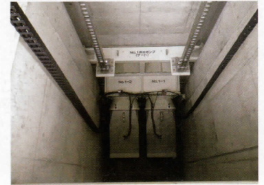
口径500mmのゲートポンプ
